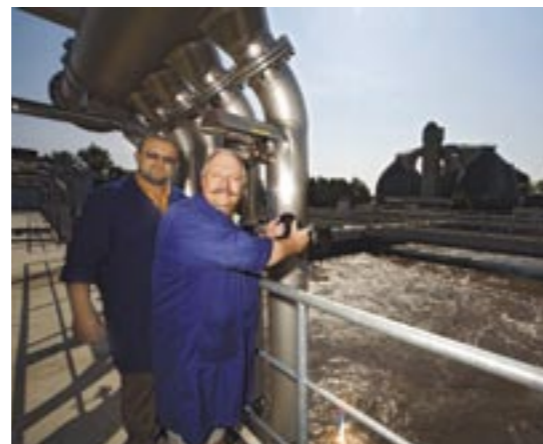
Umbau bei laufendem Betrieb: Ein Meisterstück der Werkmeister H. Windisch (l.) und M. Rupprecht.
